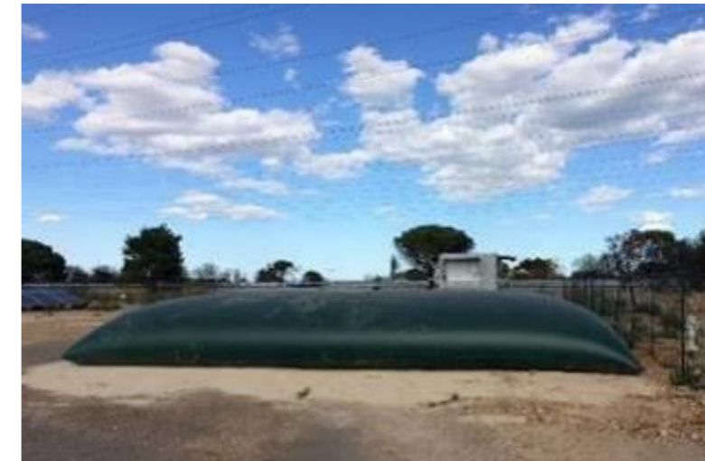
Figure 11 : Citerne souple Source : EDF Renouvelables
